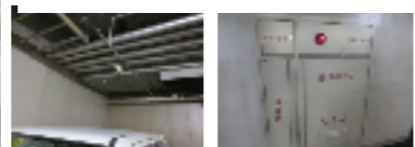
地下駐車場天井 消火設備
